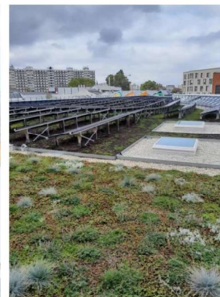
Toiture biosolaire, Bosch, Saint-Ouen
